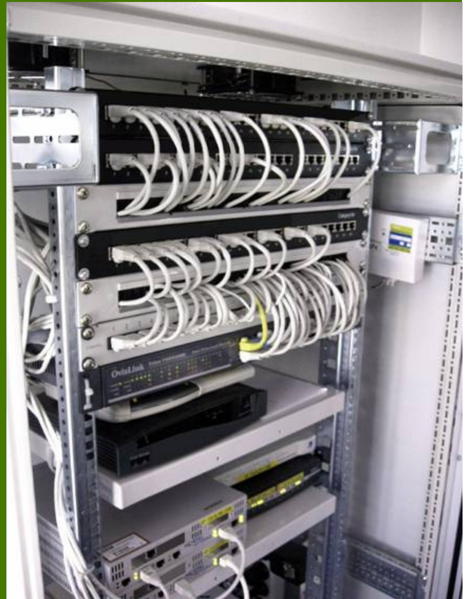
RACK de instalación y conexionado de una Red Local
